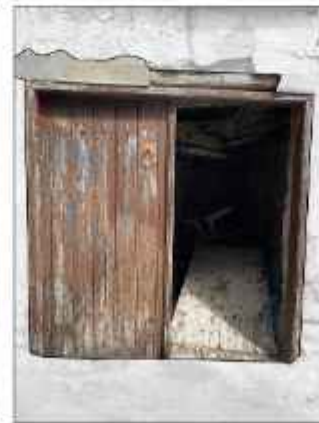
3. Φθορά εξωτερικής θύρας
